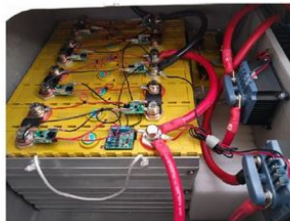
Sistema de monitoramento de baterias
